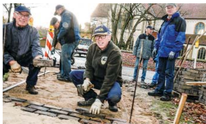
Ehrenamtlich: Leonhard Sieweke (Mitte) und Meinhard Dopheide (l.) vom Arbeitskreis Kloster helfen bei der Umgestaltung des Klosterhofs, auf dem der Diagonalweg aus Holländerpflastersteinen neu verlegt wurde. Demnächst werden Pflanzdecken, Sitzgruppen und eine Ladestation für E-Bikes installiert. FOTO: ROBERT BECKER
